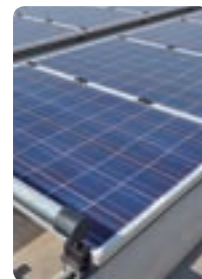
太陽光発電設備
