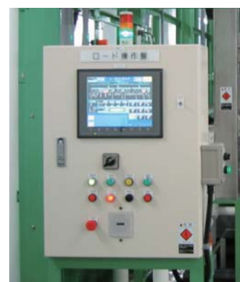
写真左・右上 装置本体操作盤 写真右下 投入部操作盤
