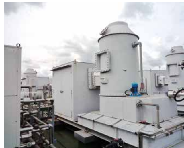
総合研究所の排気洗浄塔
