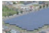
太陽光発電設備
