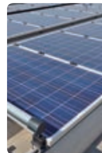
太陽光発電設備
