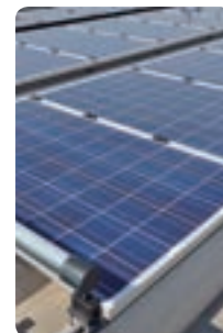
太陽光発電設備
