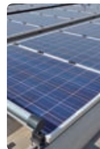
太陽光発電設備
